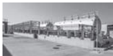
屋外タンク貯蔵所
